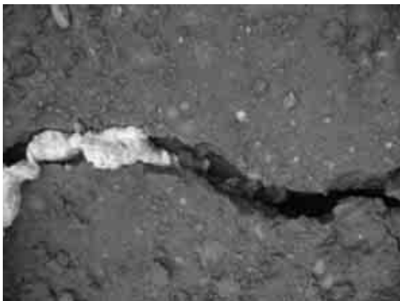
FIG. 19: SUELO CON GRIETAS DESPUÉS DE LA EXPANSIÓN DEL MATERIAL DE INYECCIÓN.
