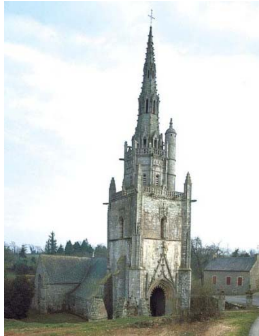
Figura 44. Vista de la torre del campanario donde se aprecia su inclinación.
