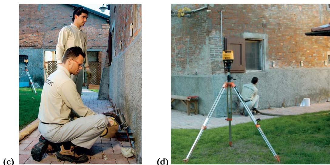
Figura 4. Fases de ejecución Uretek Deep Injections®. (c) cabeza de inyección de la resina, (d) nivel laser para el control del levantamiento.
