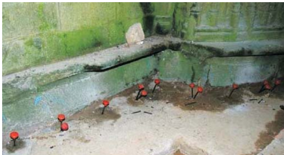
Figura 45. Situación de los taladros destinados a la inyección del campanario.
