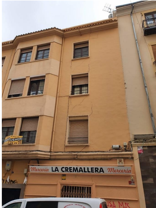
ASIENTO DIFERENCIAL EDIFICIO PLURIFAMILIAR
