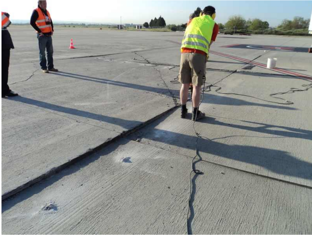
HUNDIMIENTO SOLERA / PAVIMENTO
