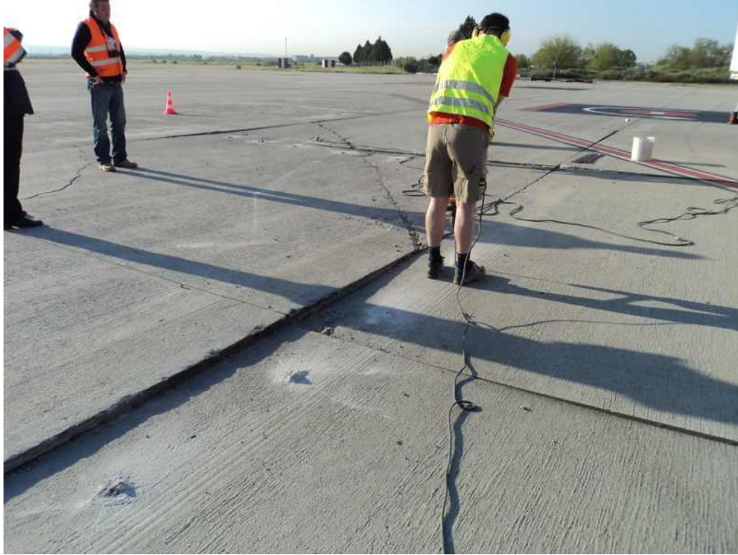
HUNDIMIENTO SOLERA / PAVIMENTO
