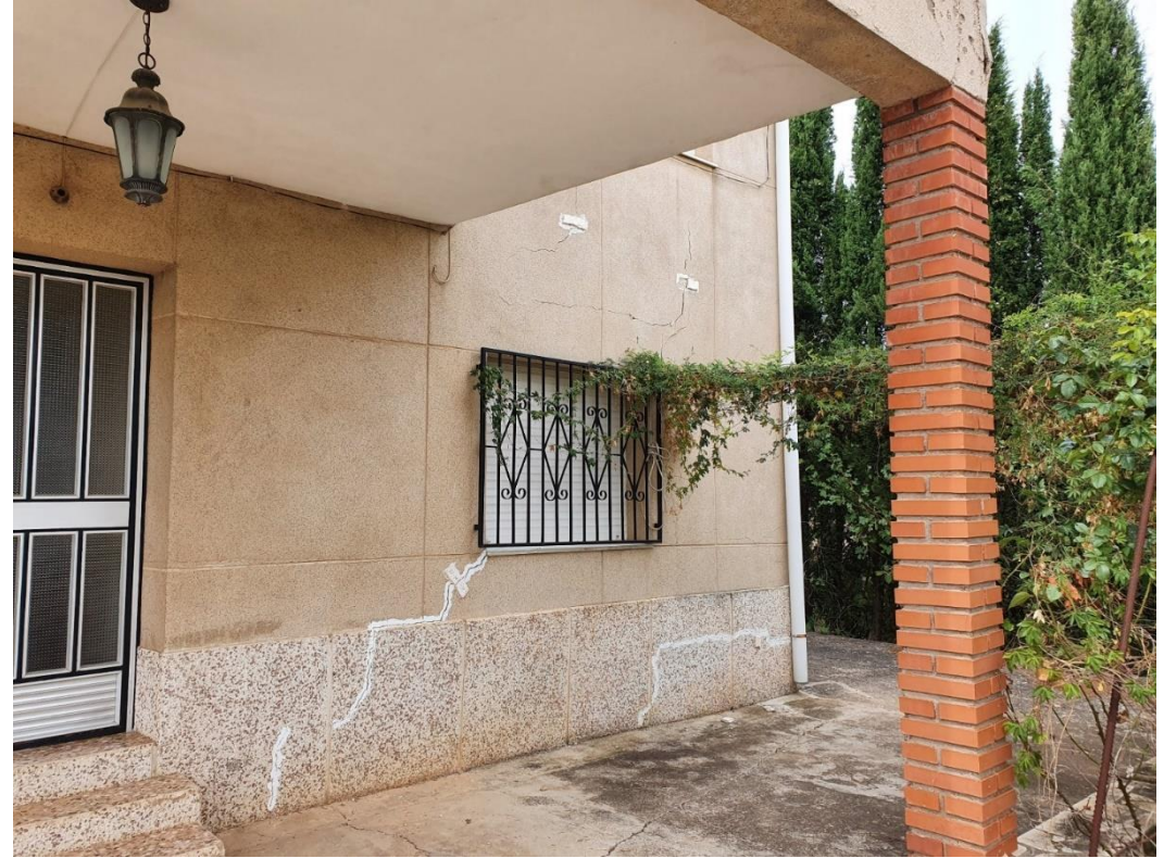
ASIENTO DIFERENCIAL VIVIENDA UNIFAMILIAR
