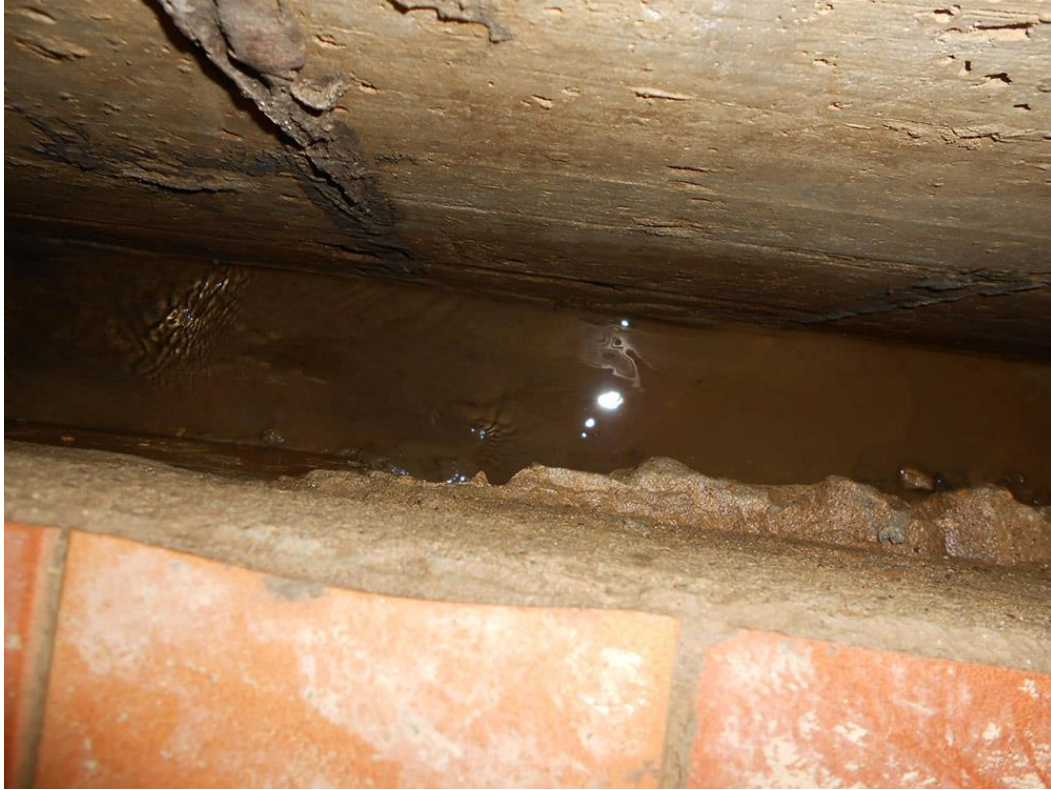
FILTRACIÓN DE AGUA EN ESTRUCTURA SUBTERRÁNEA
