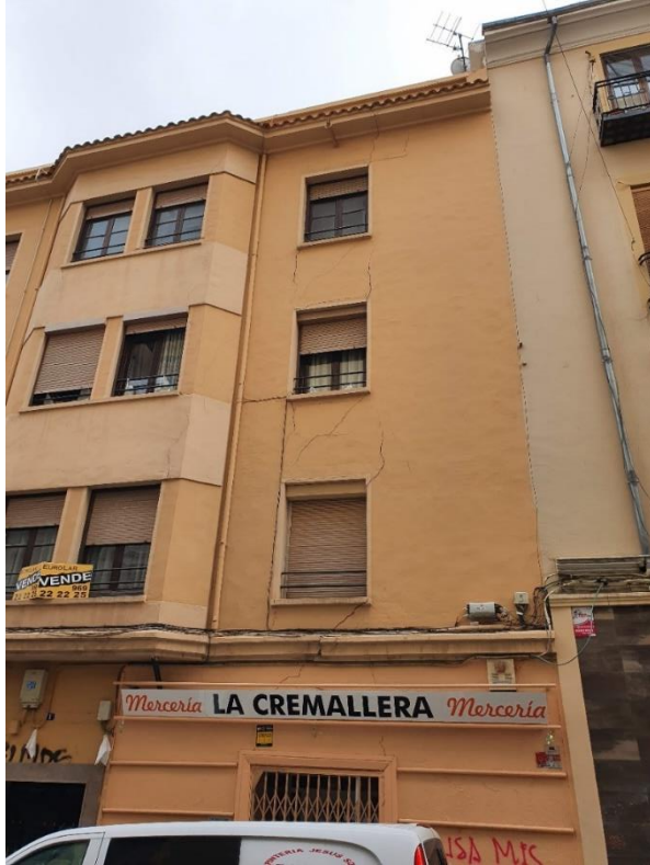
ASIENTO DIFERENCIAL EDIFICIO PLURIFAMILIAR
