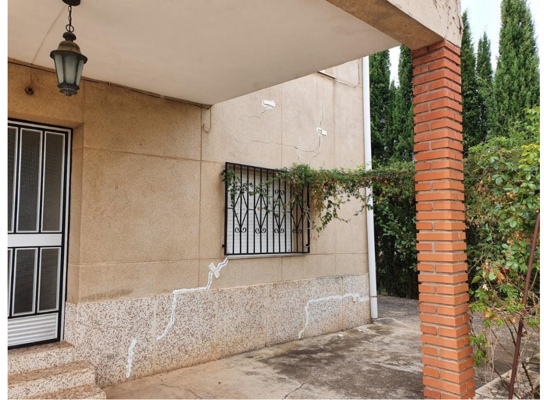
ASIENTO DIFERENCIAL VIVIENDA UNIFAMILIAR
