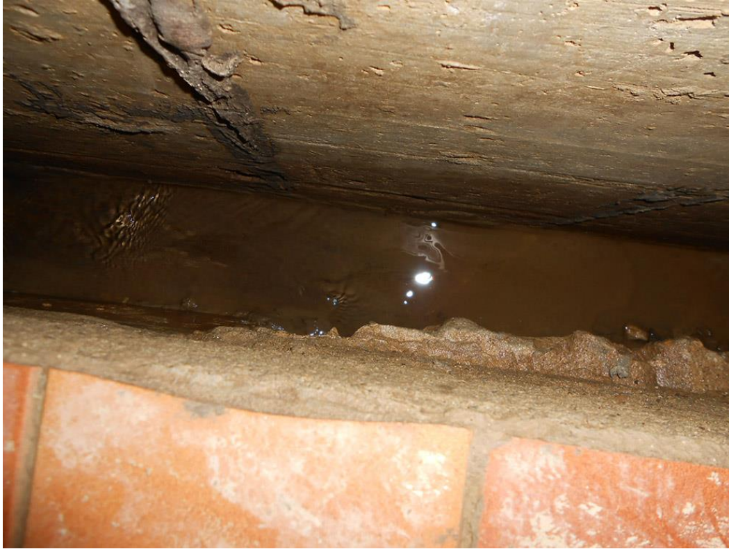
FILTRACIÓN DE AGUA EN ESTRUCTURA SUBTERRÁNEA
