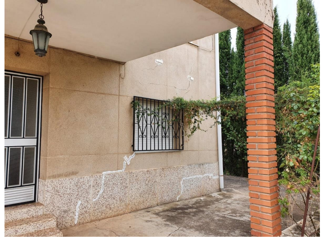
ASIENTO DIFERENCIAL VIVIENDA UNIFAMILIAR
