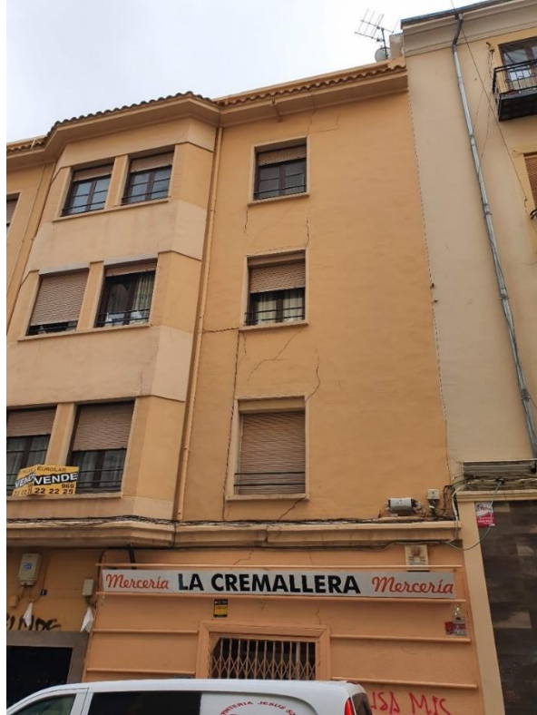
ASIENTO DIFERENCIAL EDIFICIO PLURIFAMILIAR
