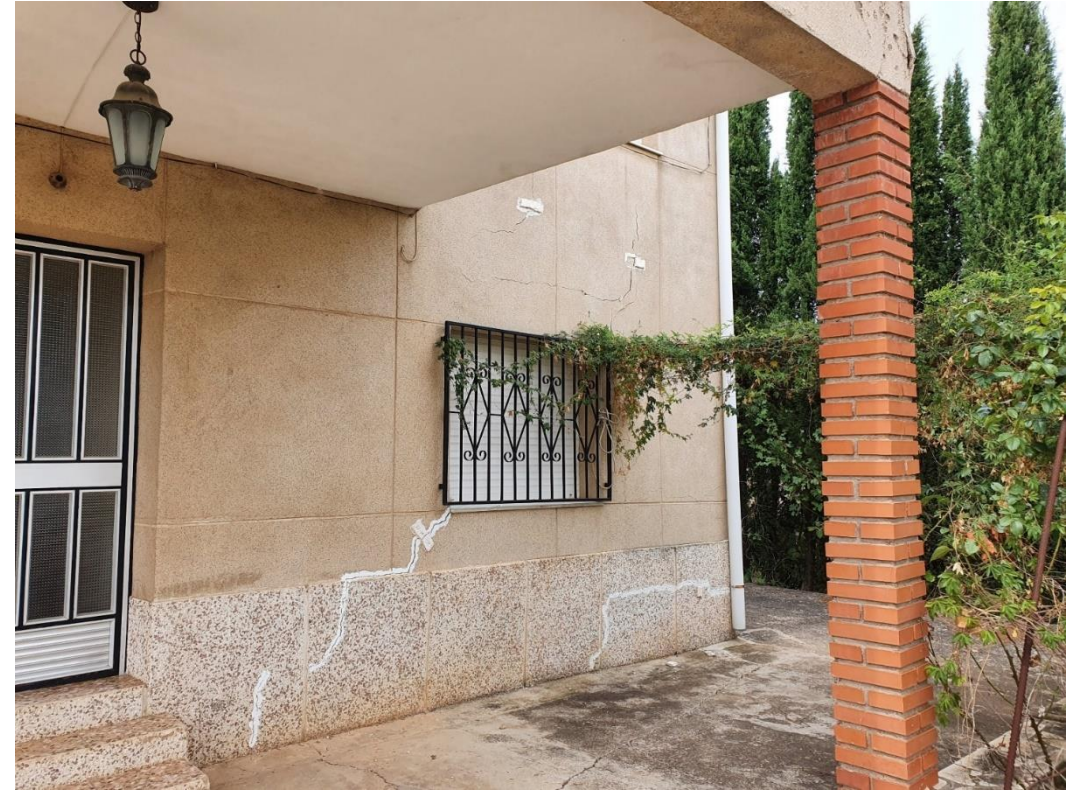
ASIENTO DIFERENCIAL VIVIENDA UNIFAMILIAR
